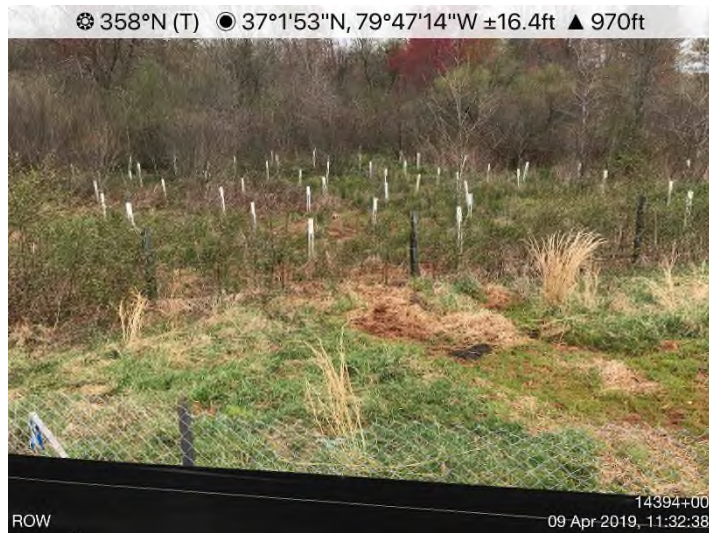
Fig. 9: STA 14393+00 – Sediment off ROW.
